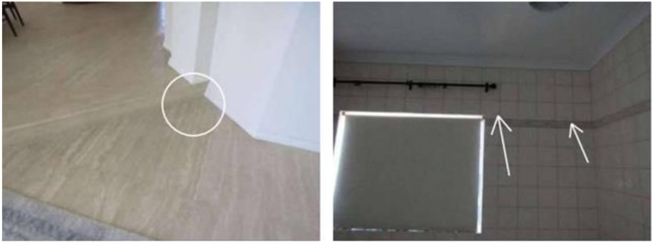
Haarrisse in der gefliesten Wand im WC und beiden oberen Badezimmern
