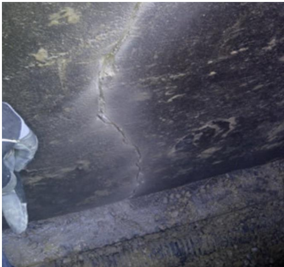
Risse im Mauerwerk
