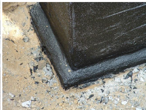
Hohlkehle wurde nicht mit Zement erstellt
